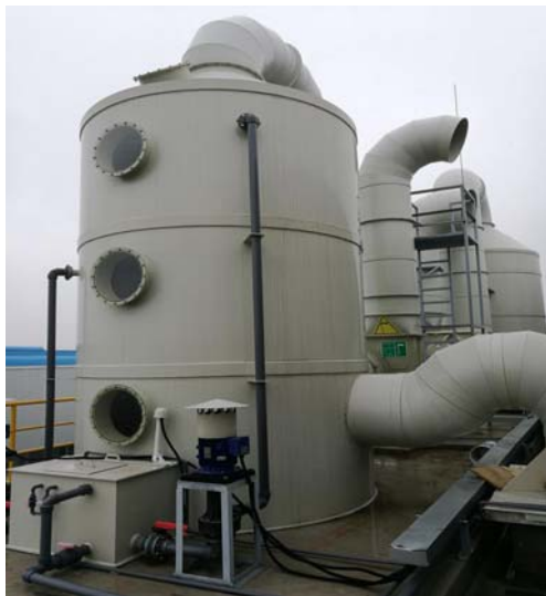
图 4.1-6 废气治理设施现场图
