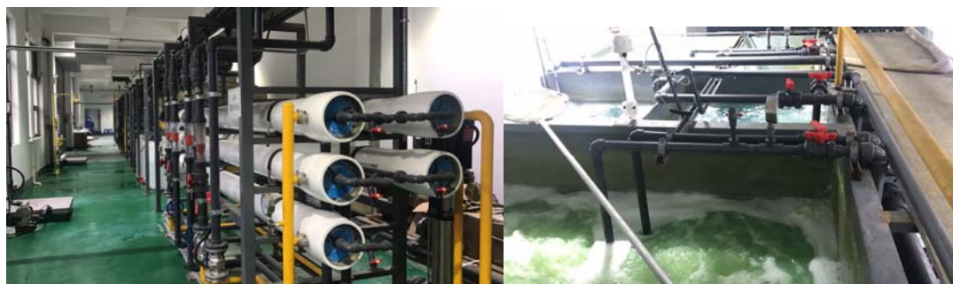
图 4.1-2 含镍废水处理设施现场图
